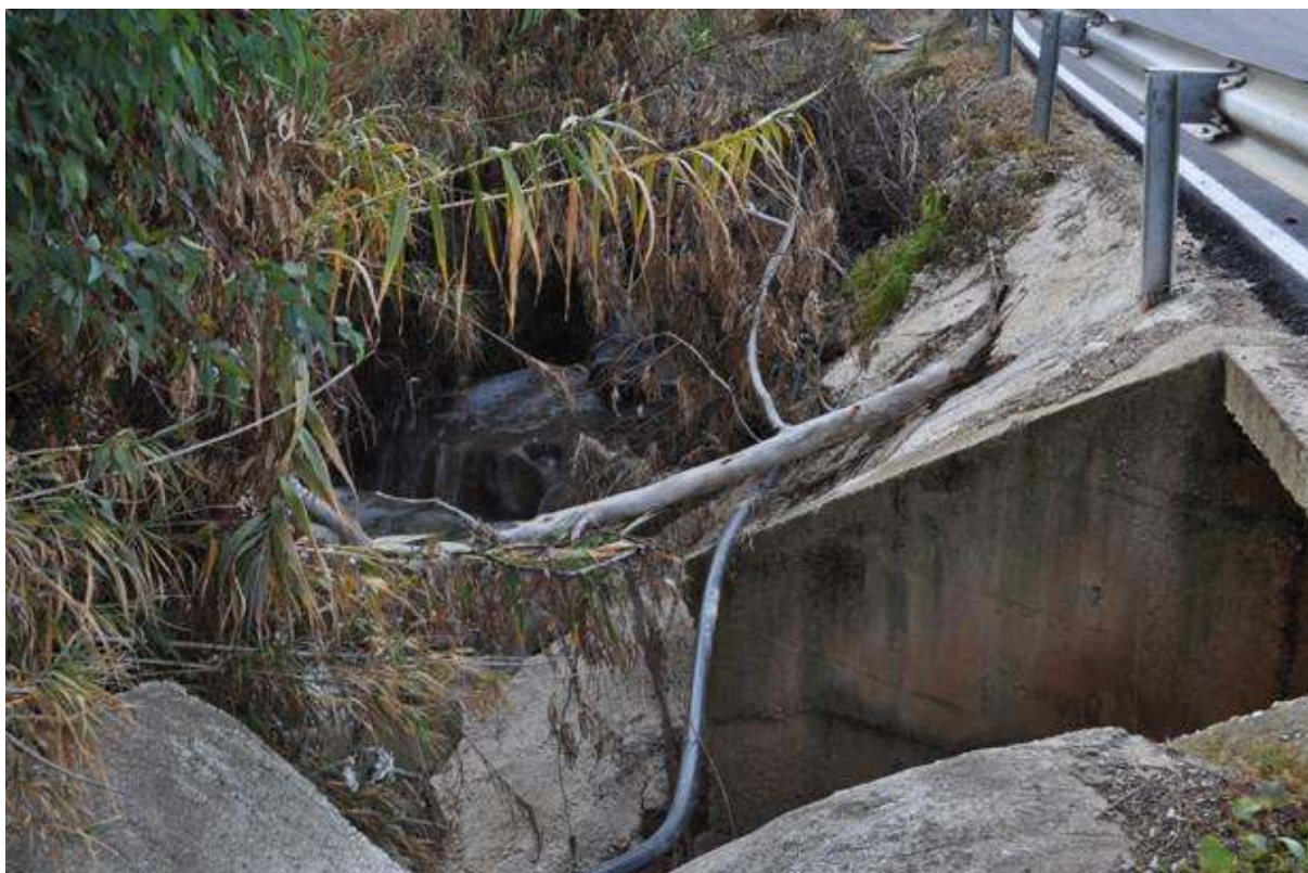
Ilustración 5: Punto de vertido de aguas residuales en Arroyo de las Monjas-Carretera de Fernán-Nuñez
